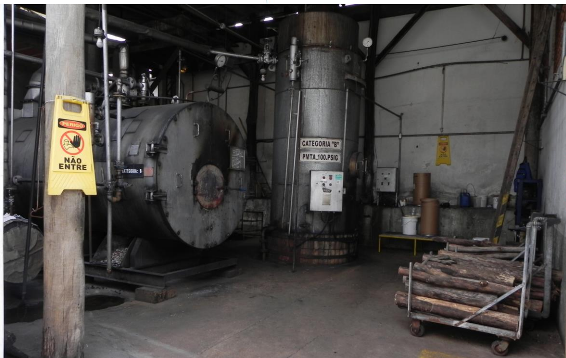
Foto 015: Sala das máquinas
