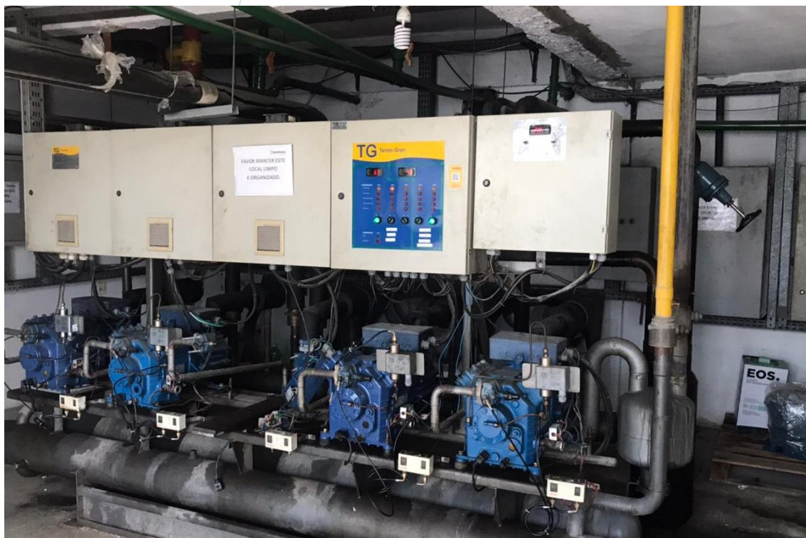
Foto 016: Sala de Máquinas
