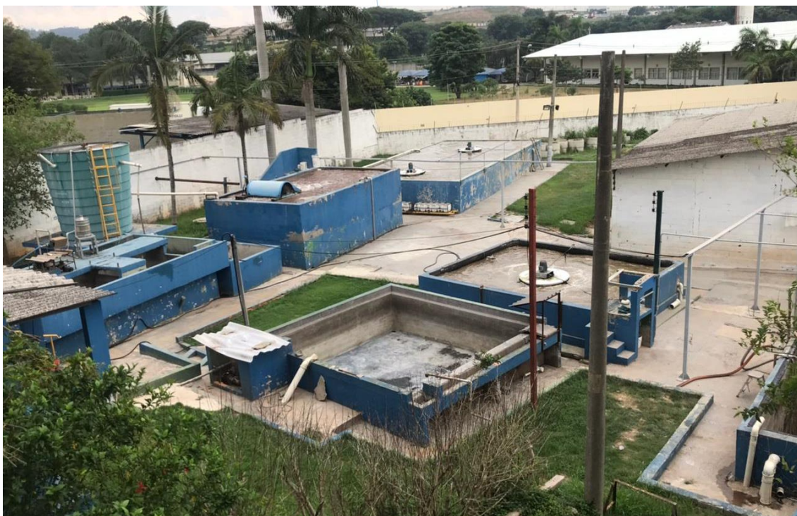
Foto 017: Estação de tratamento de água
