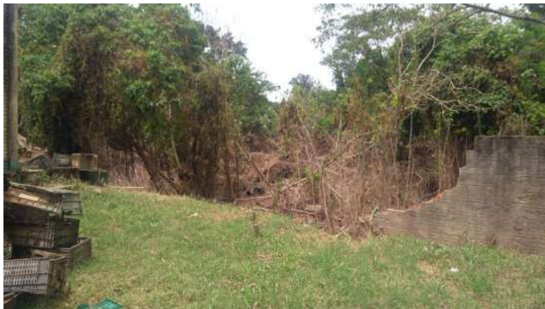
Foto 005: Muro da Recuperanda derrubado na enchente.
