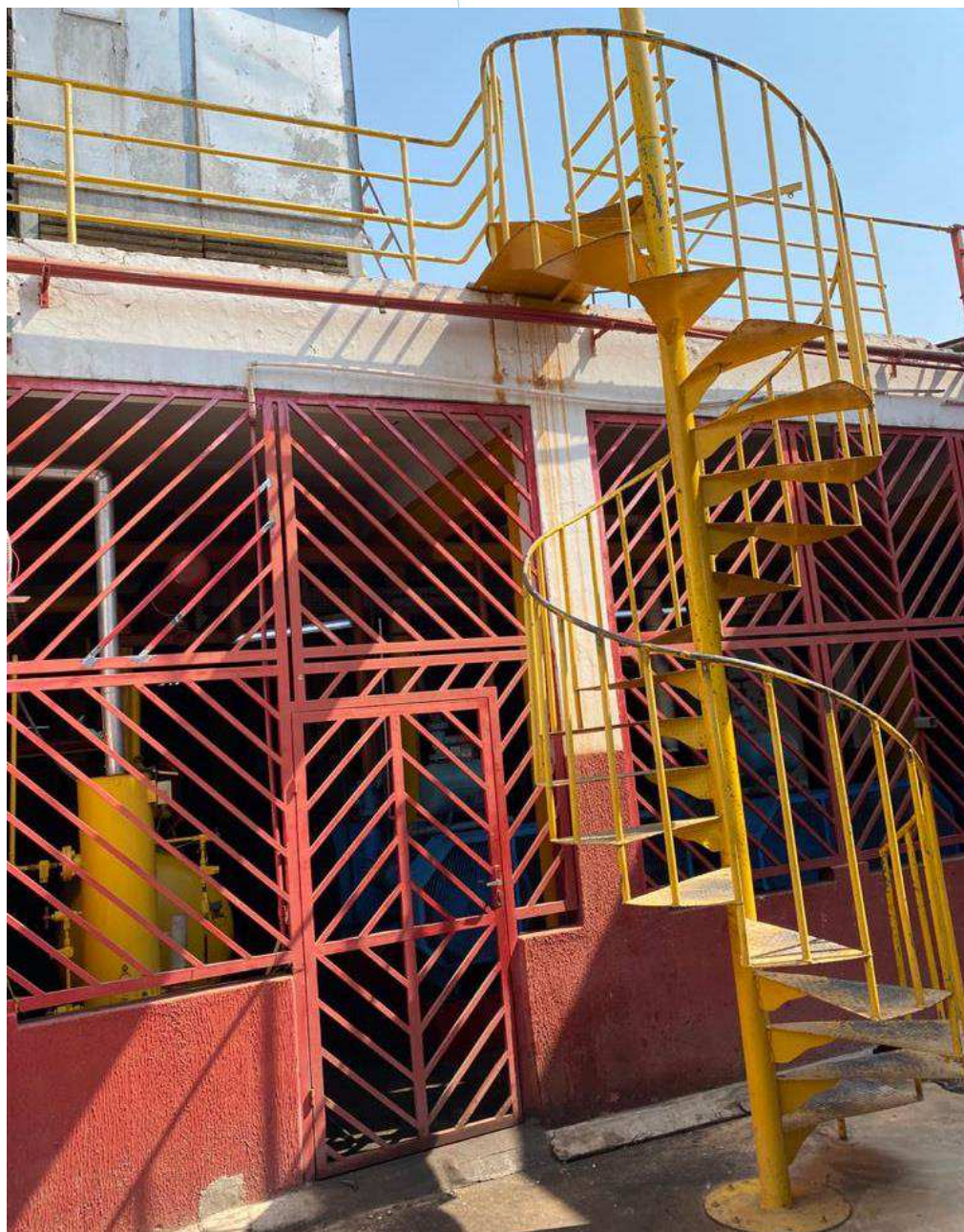
Foto 008: Sala das máquinas
