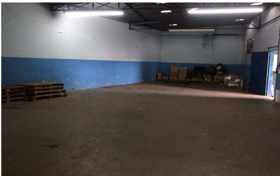
Foto 006: Galpão de armazenamento de produtos para transporte ( OBS: conforme informado no breve relatório e analisando a foto supra, verifica-se que todas as
