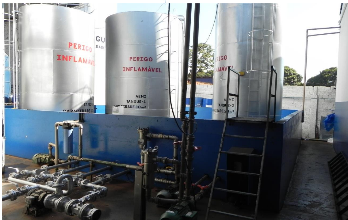
Foto 005: Depósitos de inflamáveis
