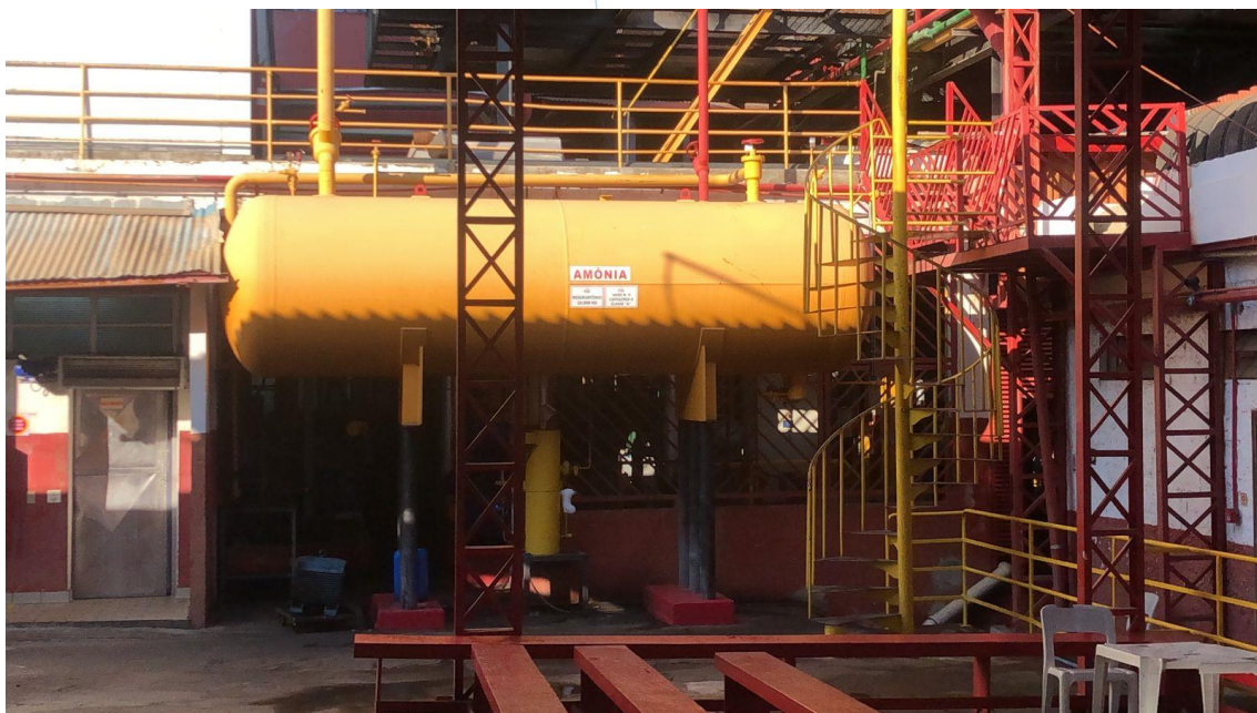
Foto 017: Tanque de amônia
