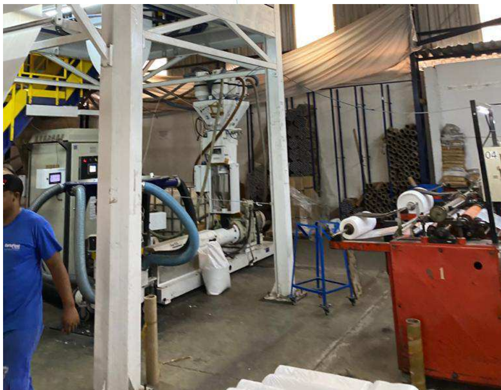
Foto 005: Setor operacional ( continuação )
