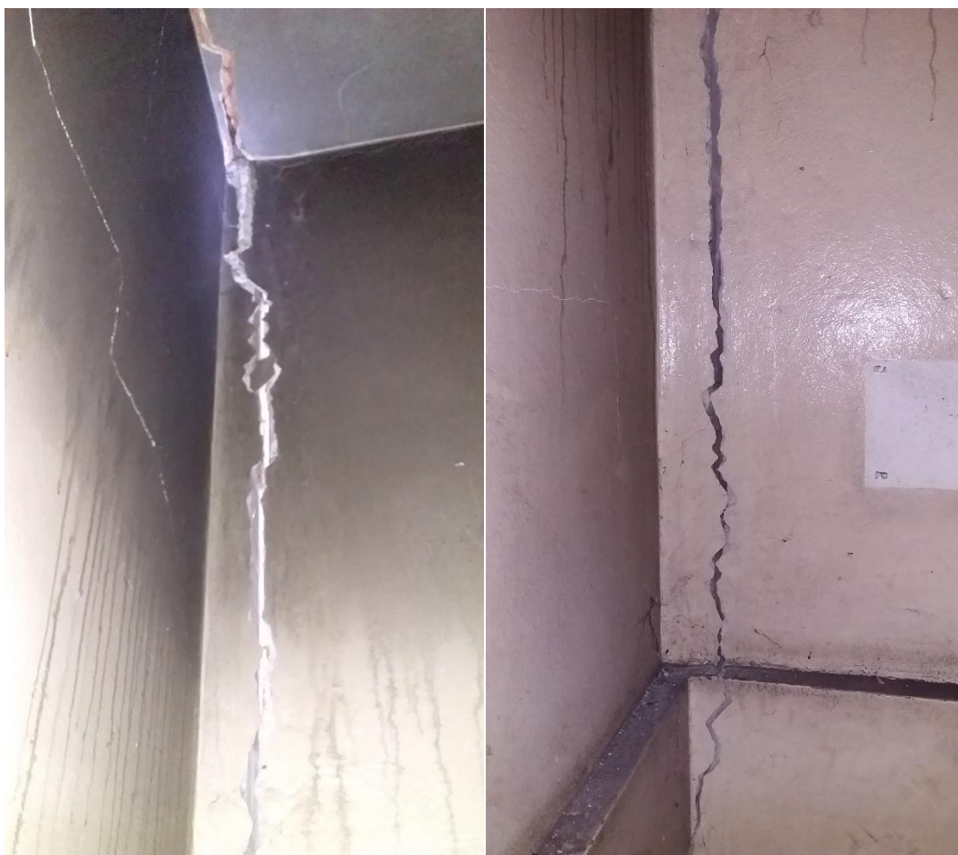
8 E 9- CORREDOR DE ACESSO AO PAVIMENTO SUPERIOR – TRINCA ESTRUTURAL
