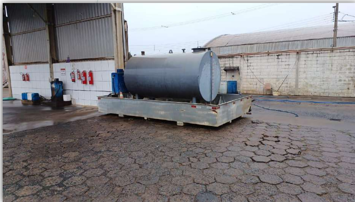
Foto 012: Tanque de armazenamento
