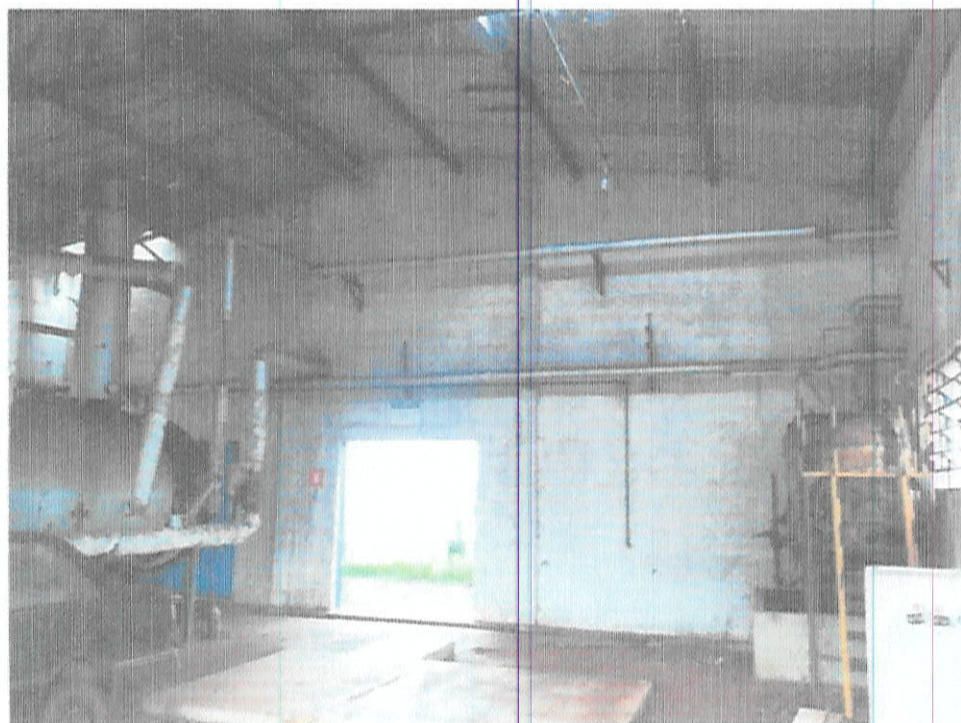
Casa de caldeiras
