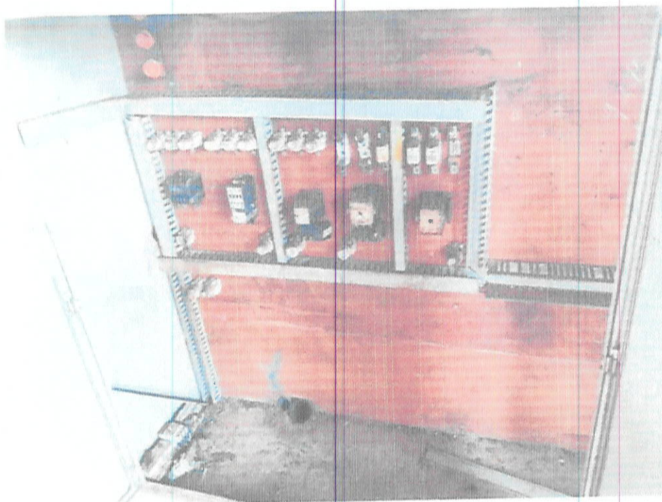
Casa de caldeiras – painel de força desmontado
