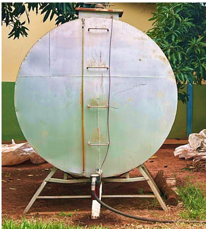
TANQUE RESERVATÓRIO DE INOX
