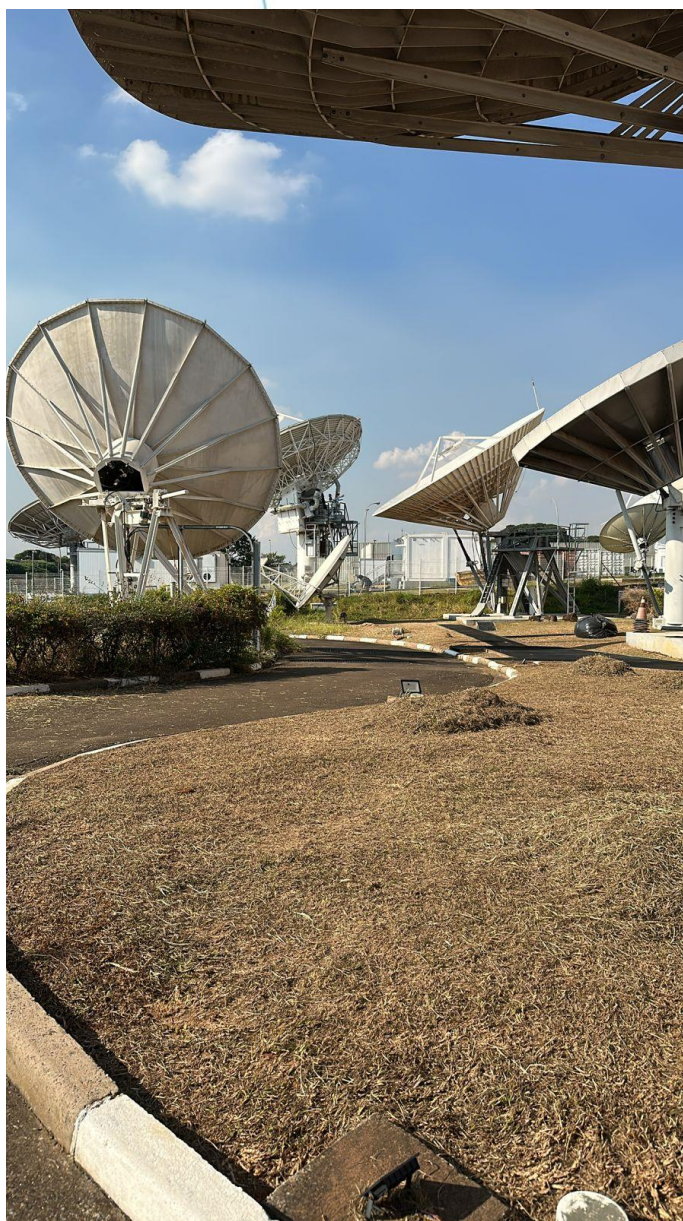
Foto 12. Antenas de Comunicação (continuação)
