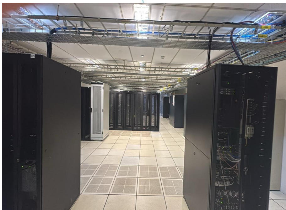
Foto 031: Data Center 2 (continuação)
