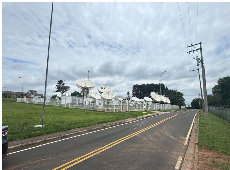
Foto 035: Pátio de Antenas ( continuação )
