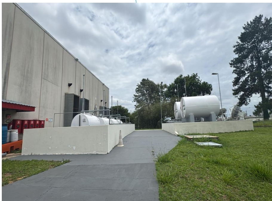
Foto 027: Tanques de Diesel
