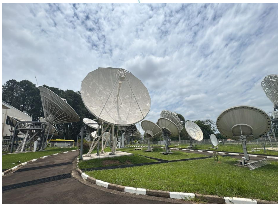
Foto 033: Pátio de Antenas ( continuação )
