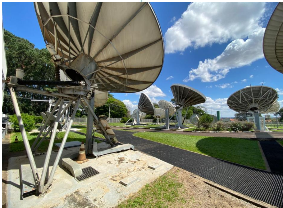
Foto 035: Pátio de Antenas ( continuação )
