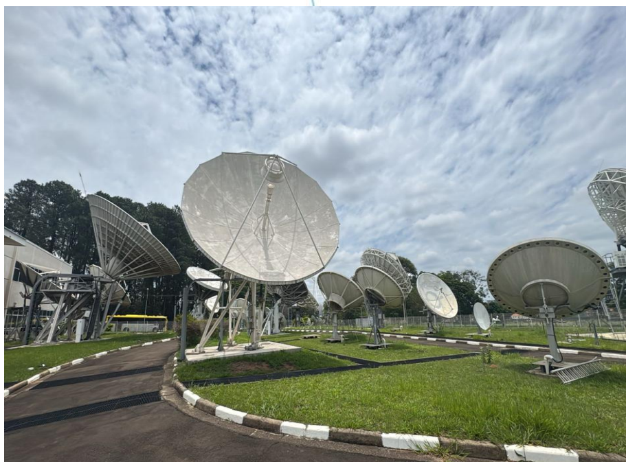
Foto 033: Pátio de Antenas ( continuação )
