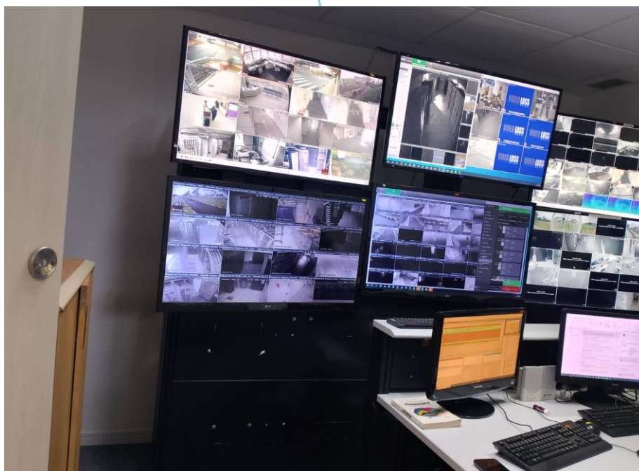
Foto 005. Sala de Controle
