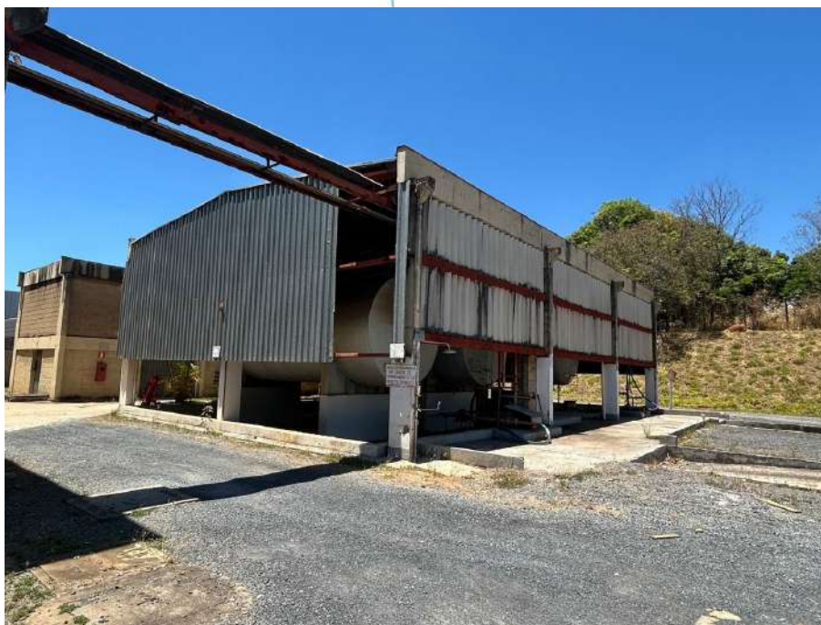
Foto 035: Tanques de TDI e Poliuri
