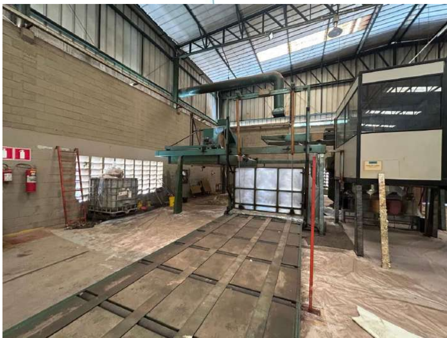
Foto 023: Parque Fabril equipamentos (continuação-12)
