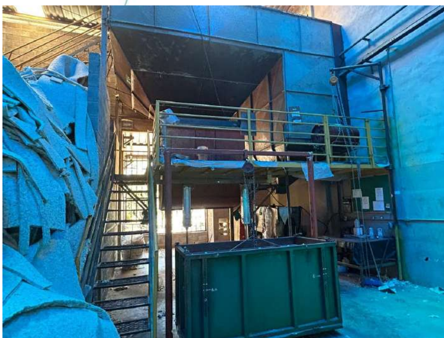
Foto 016: Parque Fabril equipamentos (continuação-05)
